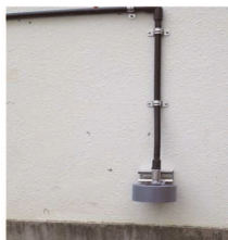
1次フィルター屋外設置
