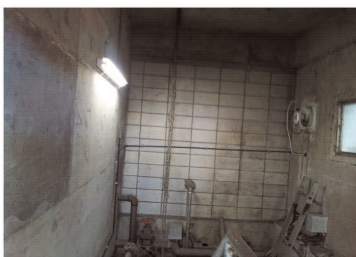
オゾン配管例・隣室より換気扇吸引
