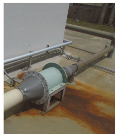
オゾン配管注入例
