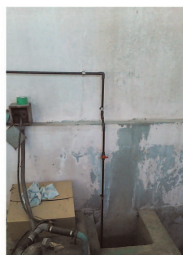
廃液配管ボールバルブ
