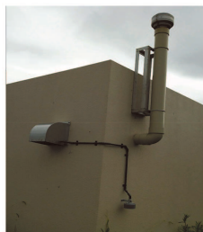
1次フィルター屋外設置例
