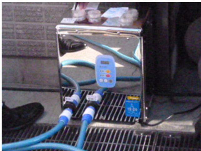
BT-01(オゾン水製造機)を作動させる。
